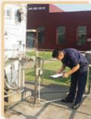
▲ 高峰供水期间检查液氧设备
