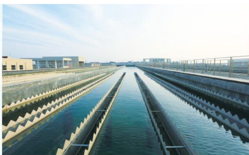
折板絮凝平流沉淀池
