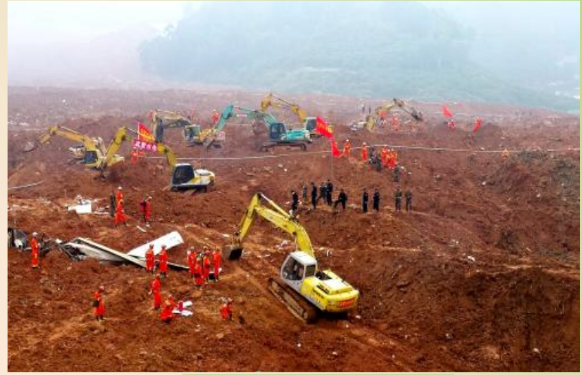
滑坡事故应急救援现场
