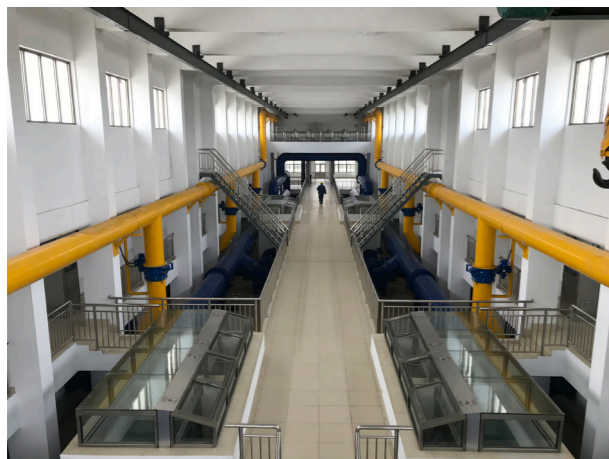
◎庙港水厂深度处理一期工程投运
