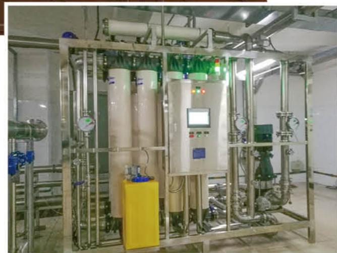
◎清源华衍水务建设的高品质水示范工程率先在苏州工业园区二次供水泵房实施并已投入使用
